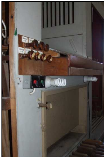
8. kép: Motorkapcsoló és pedálvilágítás
